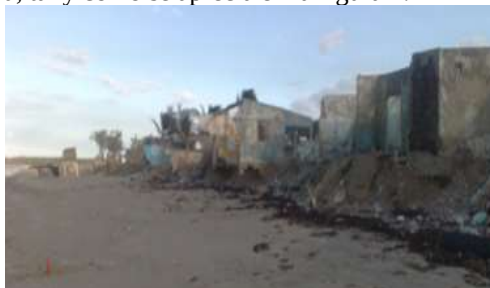
Figura 4. Imagen donde se aprecian los daños ocasionados por el oleaje en territorio de la playa; mismo que ha dañado la infraestructura restaurantera, viviendas, comercios, palapas y calles en la comunidad de Sánchez Magallanes, Tabasco.
