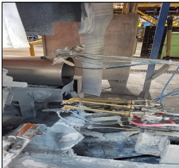
Figura 7. Rociadora de vidrio, Departamento 40.
