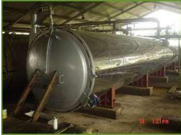
Figura 8. Esterilizador de la planta de aceite. Elaboración Propia Empresa Oleofinos del Carmen Noviembre 2016.
